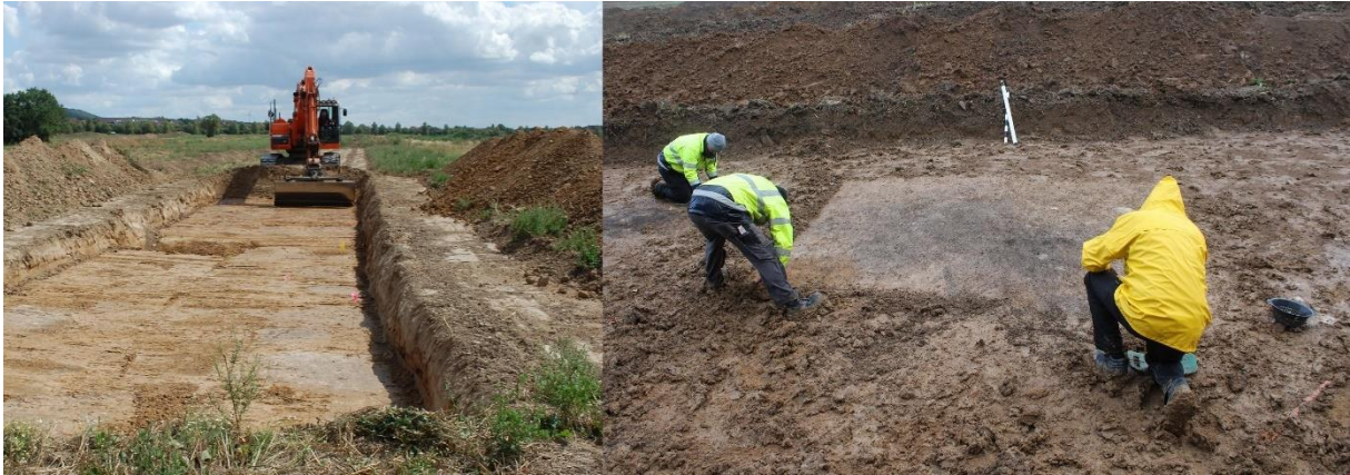
Abbildung 2: Anlegen der Suchschnitte mit dem Bagger (links, Foto Firma Arcontor) | „Putzen“ des Planums (rechts, Foto Firma ArchON Bock)
