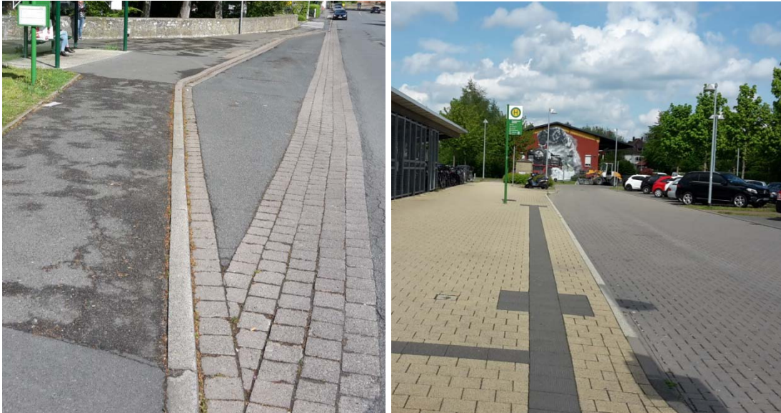
Abbildung 20: links: Busbucht mit zu kurzer Ausbildung ermöglichen kein spaltfreies Anfahren der Haltestellenkante (Beispiel: Bockenem Thornburyplatz); rechts: Aufpflasterungen bergen das Risiko der Spurrillenbildung (kein dauerhaft spaltfreies Anfahren der Haltestellenkante) (Beispiel: Nordstemmen Bahnhof)
