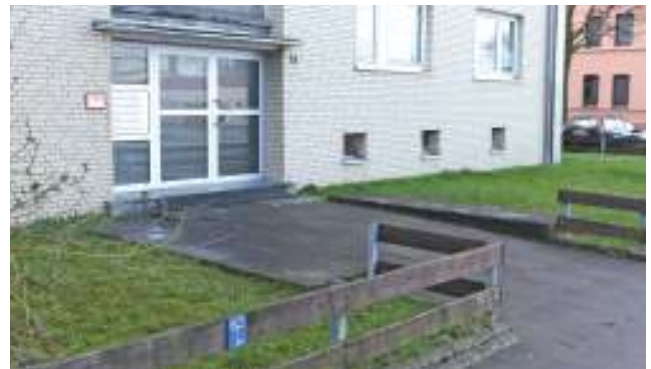
Städtebauliche Missstände vor den Eingangsbereichen
