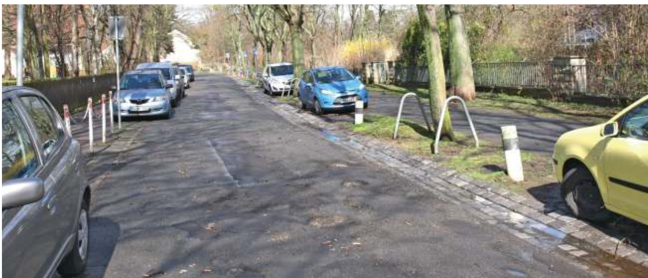
Massive Straßenschäden in der Justus-Jonas-Straße, teils unbefestigte Gehwege
