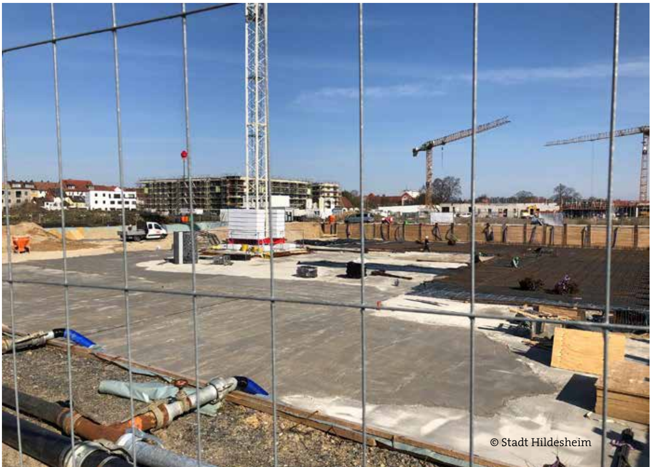
Auf den Baustellen der großen Wohnungsbaunternehmen geht es voran: Fundamentarbeiten auf einem Baufeld
