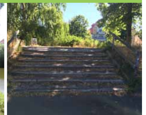
Abb. 144: Treppenaufgänge von der Straße Langelinienwall sanierungsbedürftig
