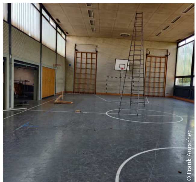
Das Gebäudeinnere der kleinen Halle ist stark sanierungsbedürftig
