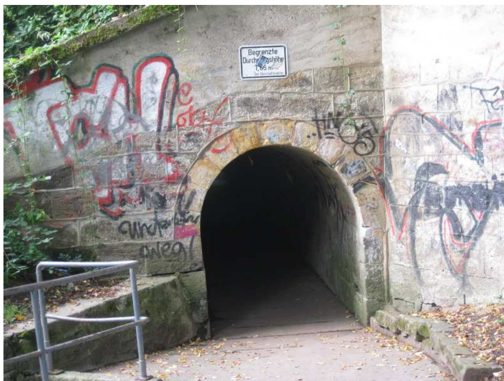
Abb. 61 Unbeleuchtete Unterführung an der Beuke
