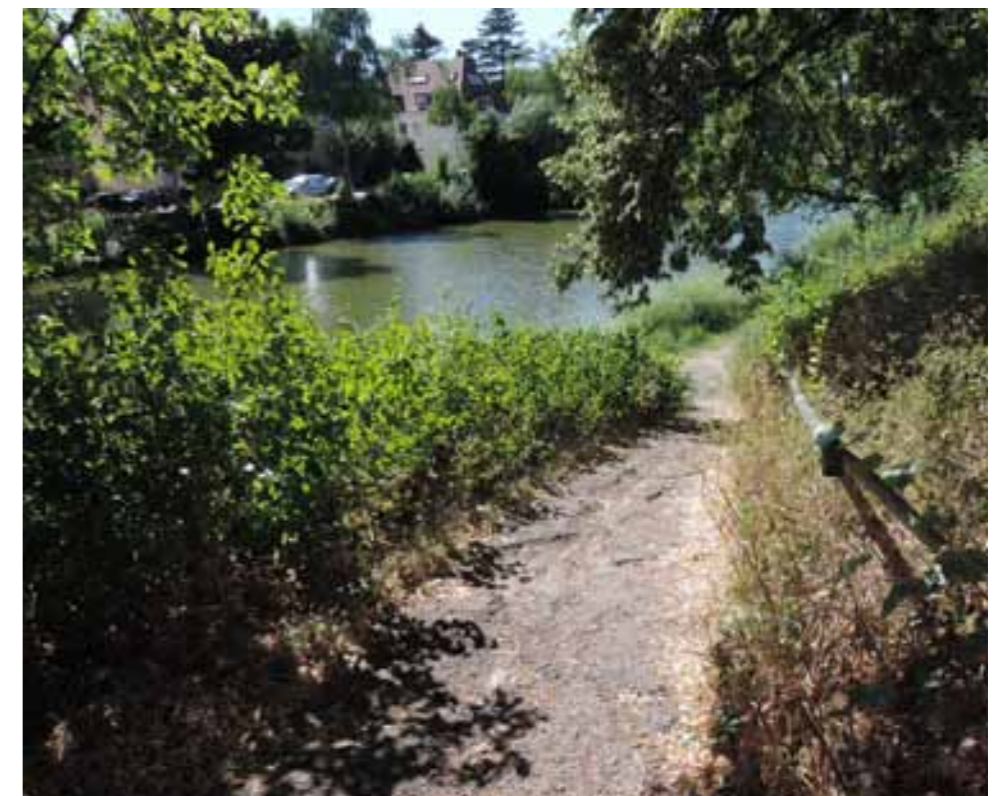
Rampe zum Uferweg sanierungsbedürftig
