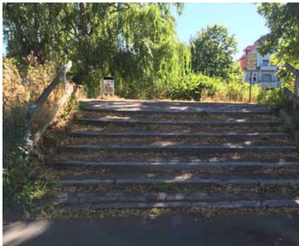
Treppenaufgänge von der Straße Langelinienwall sanierungsbedürftig
